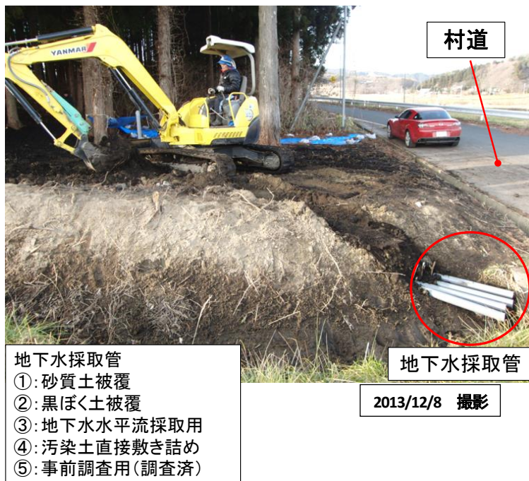
写真A2.7 除染実験地下水サンプル採取口
