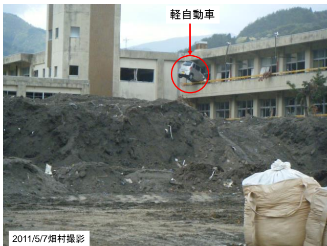
写真B1.21 被災した鶴住居小学校
