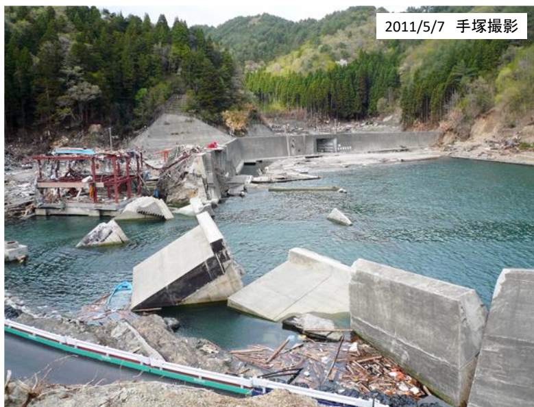
写真A2.12 両石湾奥の防潮堤 ～高さ12mの防潮堤が破壊されていた～
