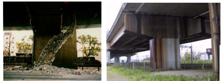
阪神高速道路 橋脚部が被災 兵庫県南部地震(震度7) / 神戸市東灘区 新潟県中越地震 鋼板巻き立てにより被災なし 新潟県中越地震(震度7) / 長岡市十日町
